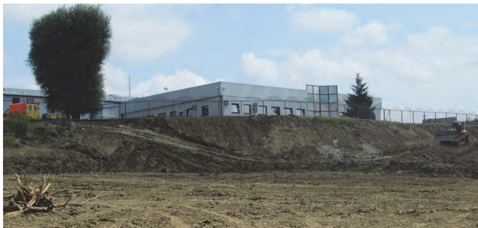
Rys. 6. Podcinanie sukcesywne skarpy zbocza przez roboty sąsiada
