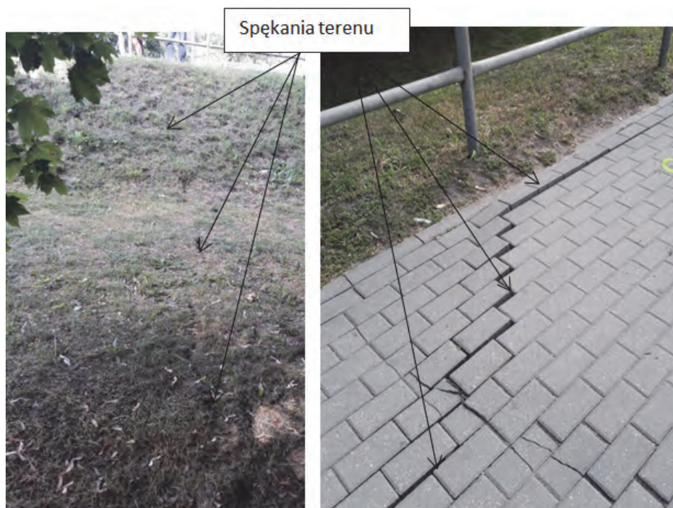
Rys. 3. Spękania terenu przy moście w ciągu drogi nr 182
