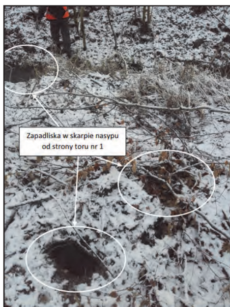
Rys. 4. Przykład zapadlisk gruntu widocznych w skarpie nasypu od strony toru nr 1
