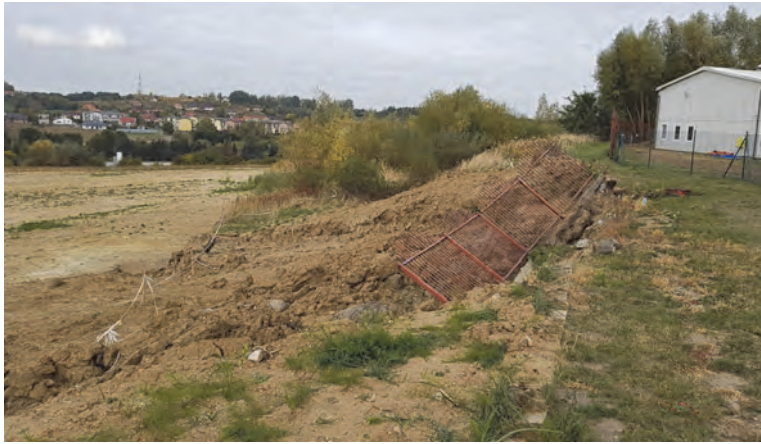
Rys. 8. Uruchomienie osuwiska po podcięciu skarpy – widoczne zapadnięcie naziomu górnego, powstanie niszy i zniszczenie ogrodzenia
