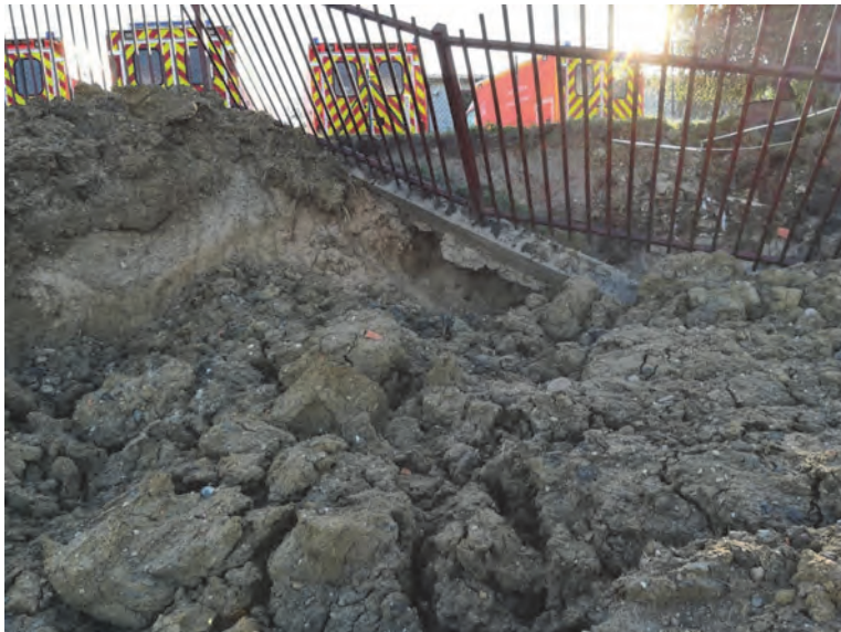
Rys. 9. Skutki uszkodzenia górnego naziomu skarpy na skutek podcięcia skarpy na działce sąsiedniej
