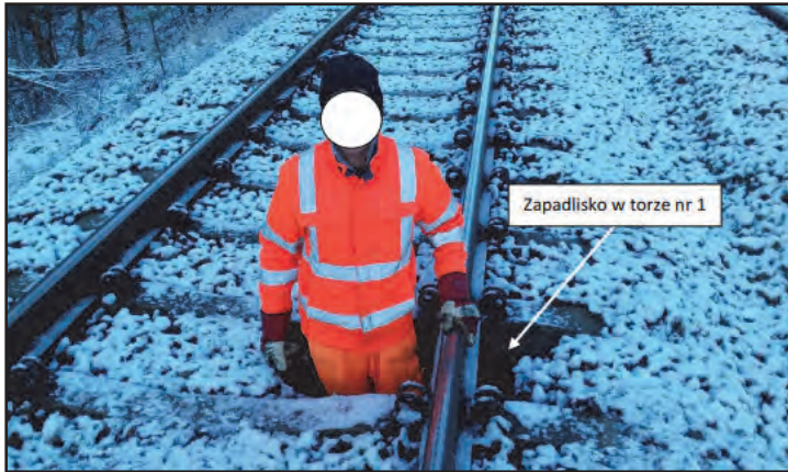
Rys. 6. Widoczne zapadlisko w torze nr 1
