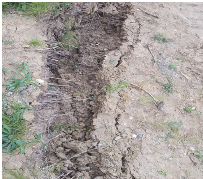
Rys. 10. Widok pęknięć szczelinowych świadczących o postępującej niestępczości skarpy poza dotychczasowym klinem odłamu
