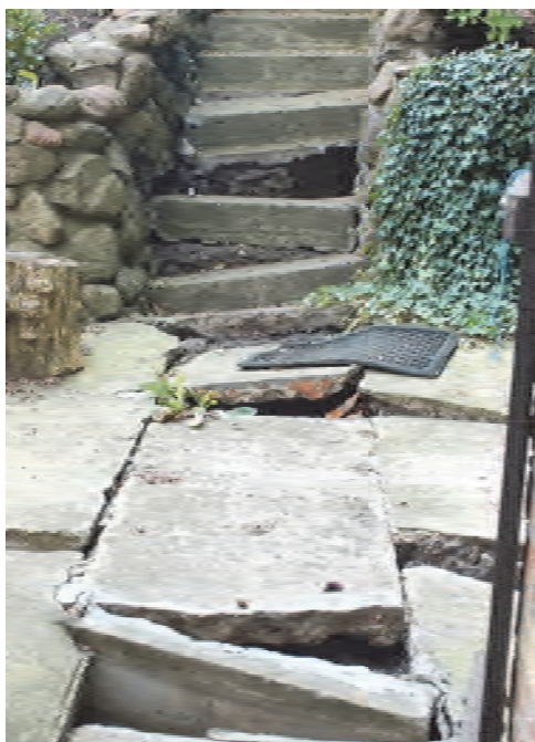
Rys. 8. Zniszczenia terenu ogrodów działkowych
