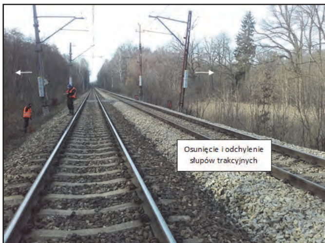
Rys. 7. Widoczne osunięcie i odchylenie słupów trakcyjnych
