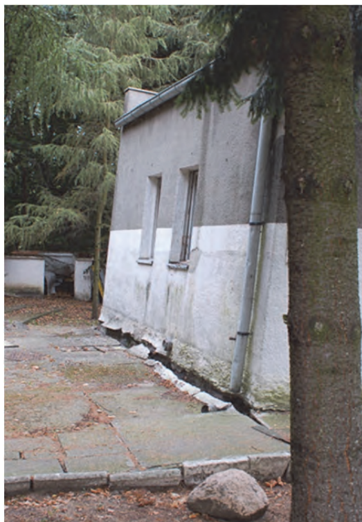
Rys. 4. Przechylony budynek na terenie nieczynnej oczyszczalni ścieków Zakładu Karnego
