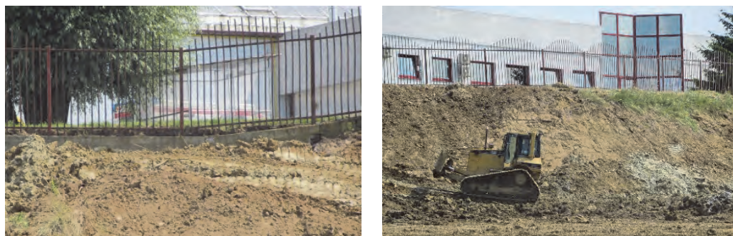
Rys. 7. Początek osuwiska wywołanego podcięciem skarpy - widoczne zapadnięcie się ogrodzenia
